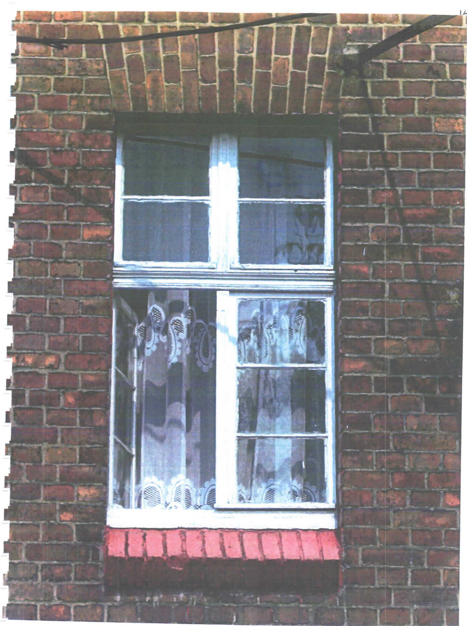
foto: OKNO ORYGINALNE w budynku Kombatantów 2 wzór: DO ODTWORZENIA FAZOWANIE NA ŚLEMIENIU I RUCHOMYCH SŁUPKACH
